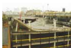
Рис.3. 20 марта 1997 года. Великобритания, г. Вулверхэмптон. Частичное обрушение многоуровневой парковки
