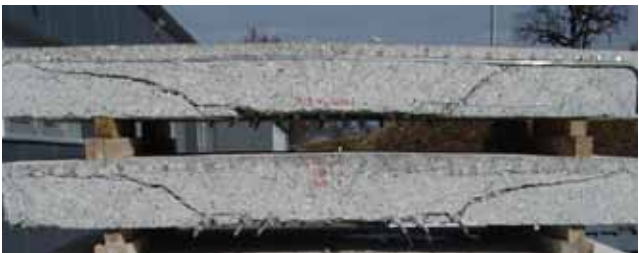
Рис.10. Характер разрушения усиленных плит перекрытия.
