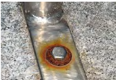
Рис. 12. Стандартный случай контактной коррозии. В данном соединении используется оцинкованная углеродистая сталь (шайба) и нержавеющая сталь (шуруп и деталь). Площадь поверхности более благородного металла (нержавеющей стали) больше, что приводит к возникновению сильной коррозии шайбы.
