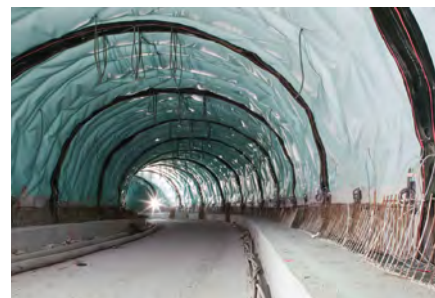
Рис. 26. Автодорожные тоннели представляют собой очень агрессивную коррозионную среду (по причине использования противообледенительного состава и наличия выхлопных газов от проезжающих транспортных средств).
